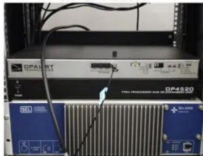
实时仿真硬件和SEL-3355 数据处理中心
