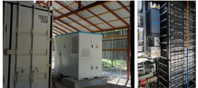
图9：为海地一所医院提供24小时不间断可靠电力供应的锂离子电池储能系统。光伏发电是主要电力来源，辅以两台柴油发电机。
