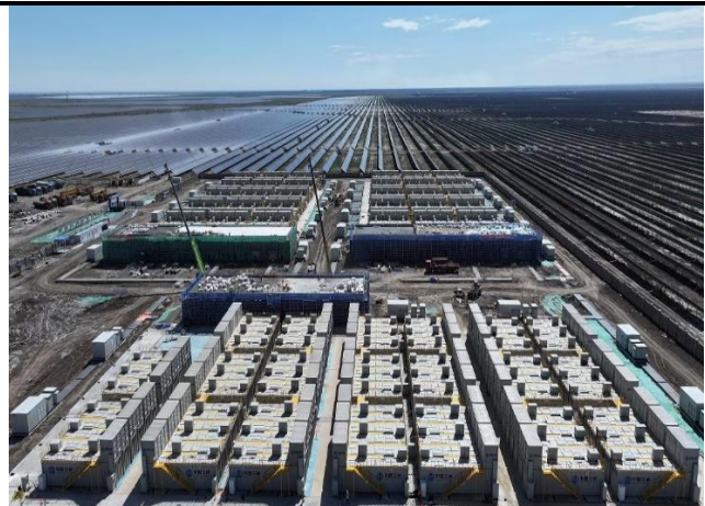
图 28：三峡集团吉木萨尔全钒液流储能一体化项目
