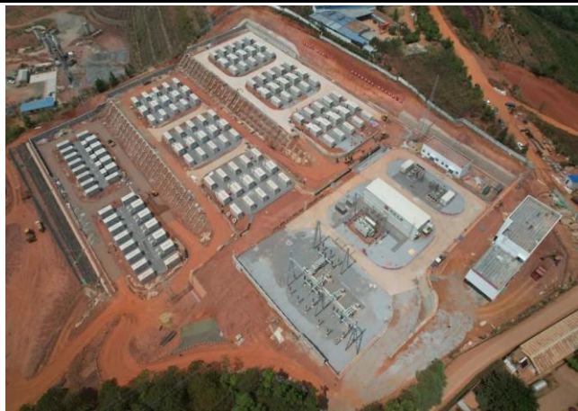
图 26：大唐云南玉溪新平县锂离子电池储能示范项目
