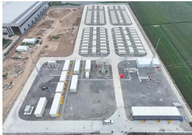
图 31：华润电力阜城 100 兆瓦/400 兆瓦时储能电站
