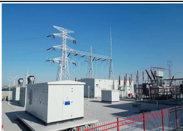
图 21：国家电投集团河北公司海兴新型储能项目
