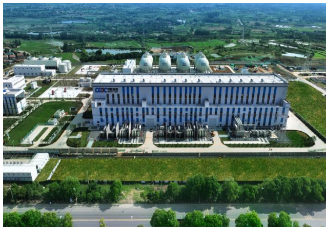
图 39：“能储一号”世界首座 300 兆瓦压气储能工程
