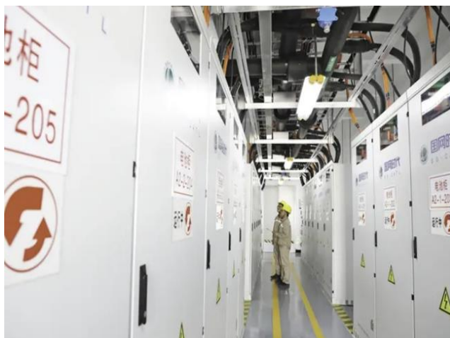
图 41：福建吉瓦级宁德霞浦储能项目
