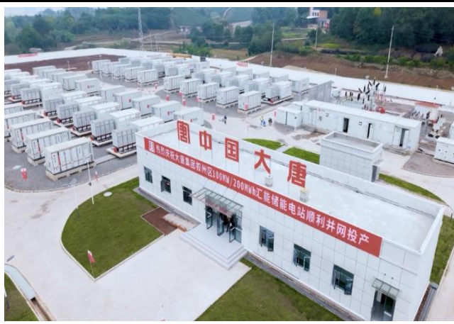
图 27：大唐四川宜宾叙州区电化储能电站
