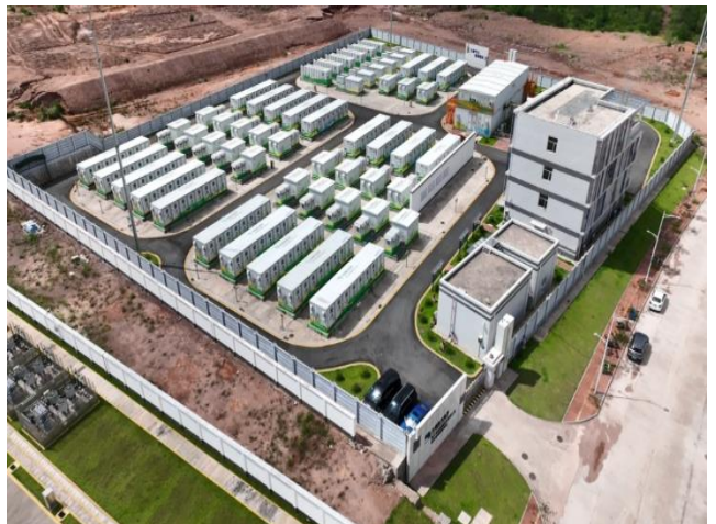
图 17：南网储能宝湖储能站
