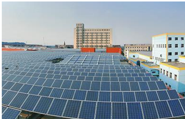
图 7：屋顶分布式光伏电站
