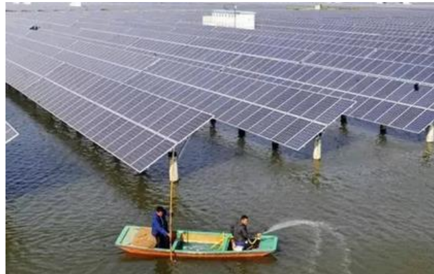
图 8：渔光互补光伏电站
