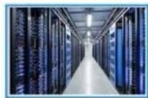
数据中心（UPS等）
